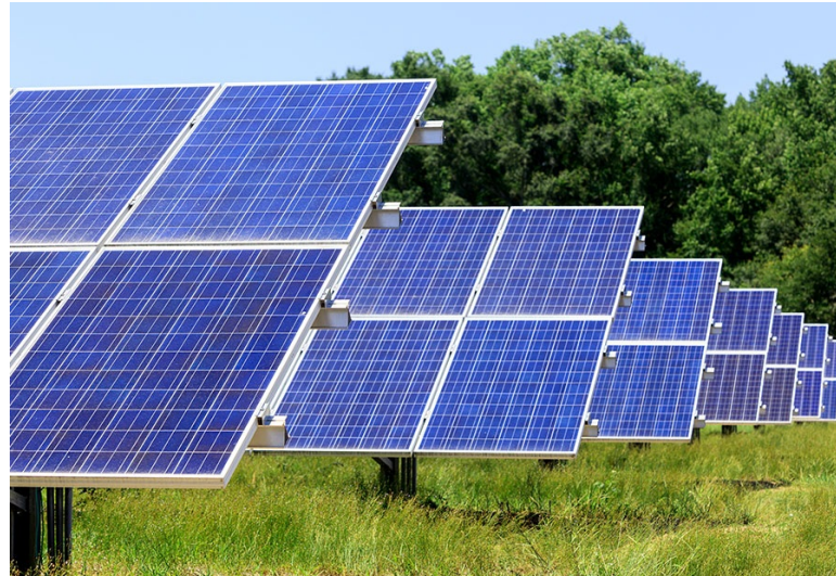
Figura 14: Instalación de energía solar fotovoltaica (fuente: Poweringsc)
